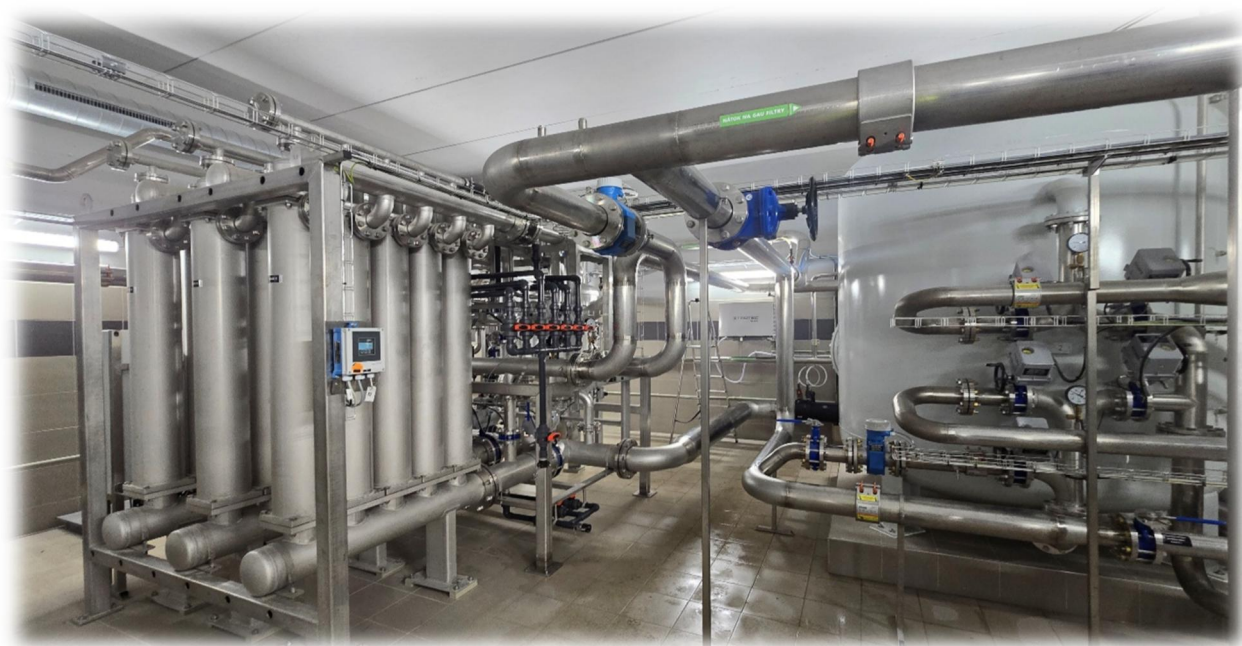
ÚV Kašparov – technologie membránové filtrace
