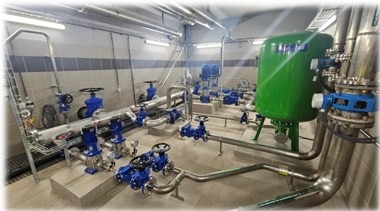
ÚV Kašparov – technologie, armaturní komora
