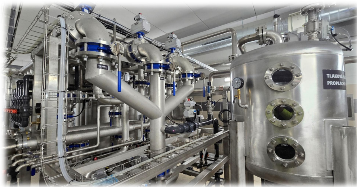
ÚV Kašparov – technologie membránové filtrace
